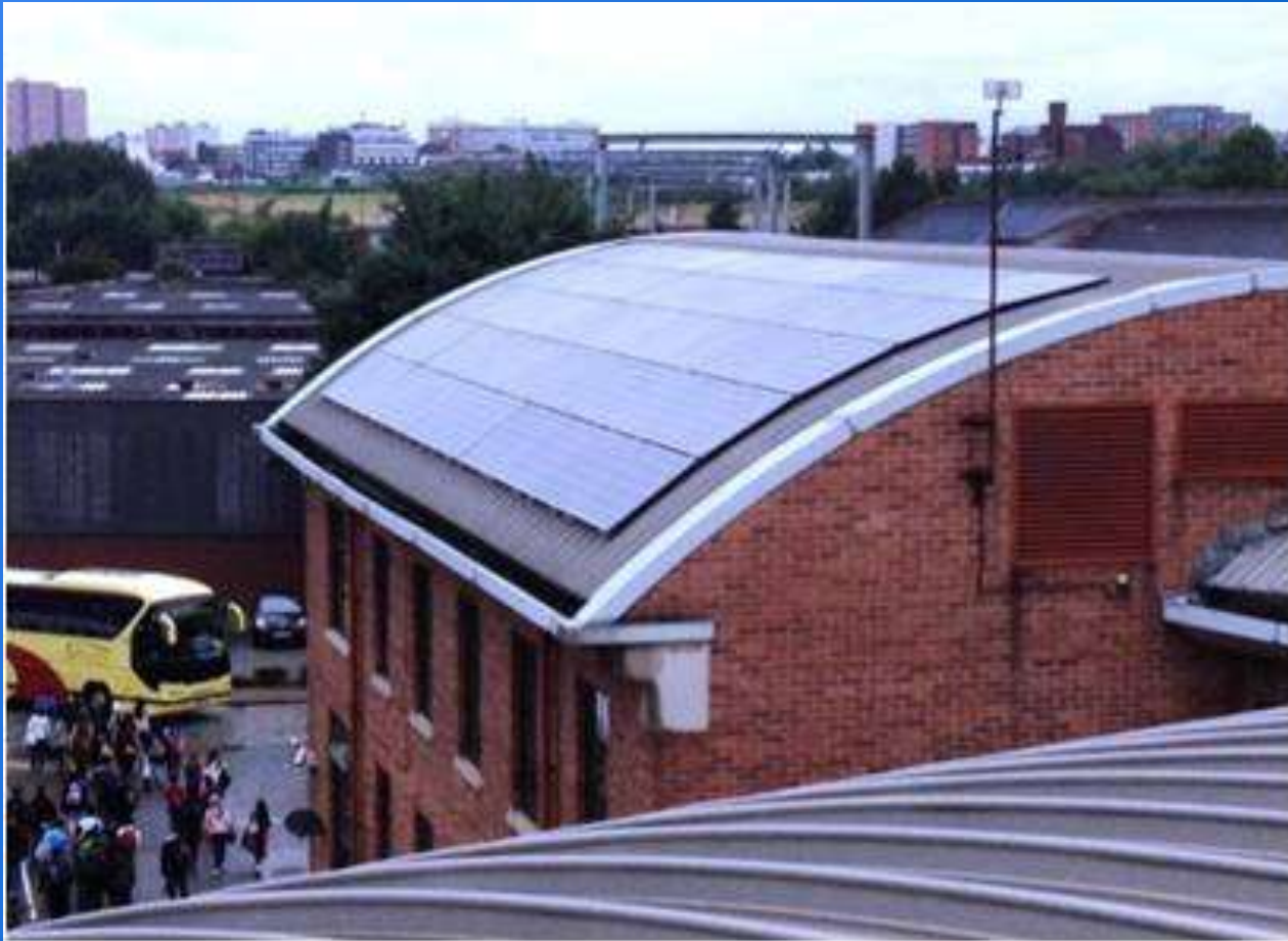
YHA Hostel Manchester 30 kW PV array
